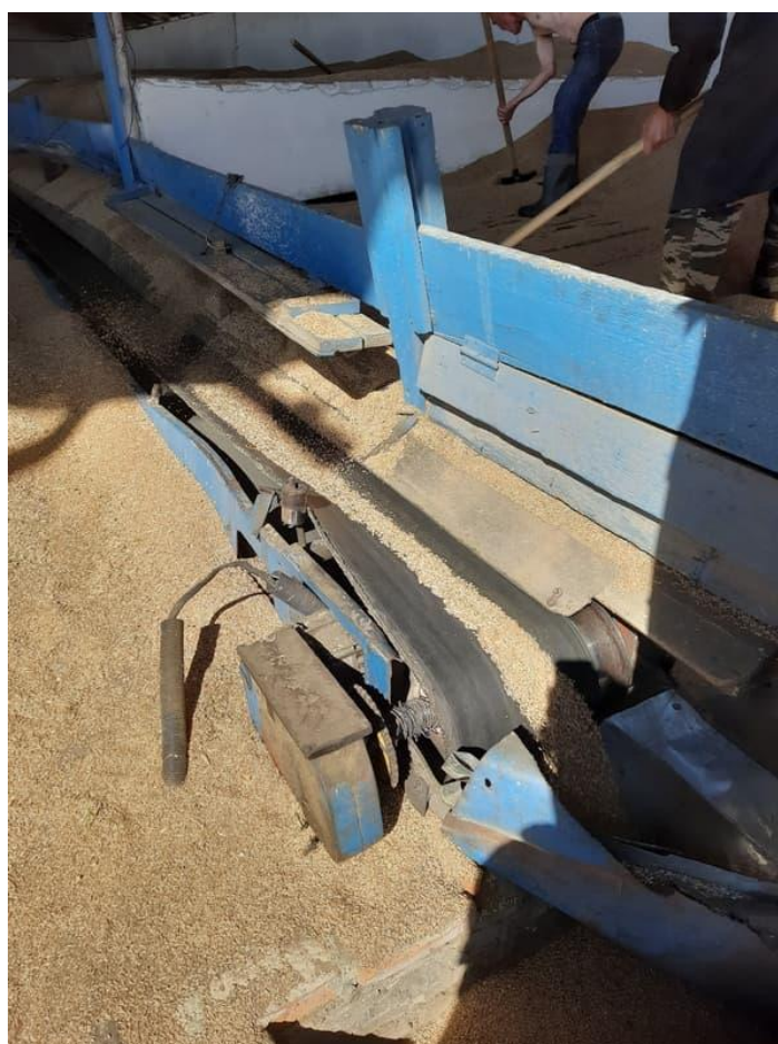
Отсутствует надлежащее крепление к фундаменту привода ленточного конвейера. Отсутствует ограждение вращающихся элементов (звездочка, ведущий барабан) привода ленточного конвейера
