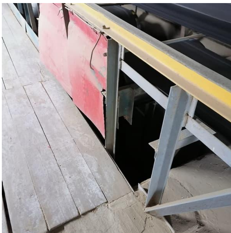
Не закрыт проем для доступа в подконвейерное пространство
