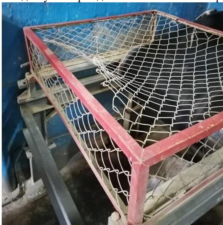
Повреждено защитное ограждение оголовка конвейера
