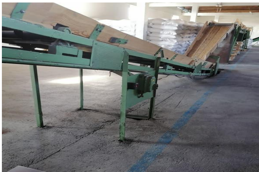
Конвейер не оборудован устройством для его остановки из любой его точки
