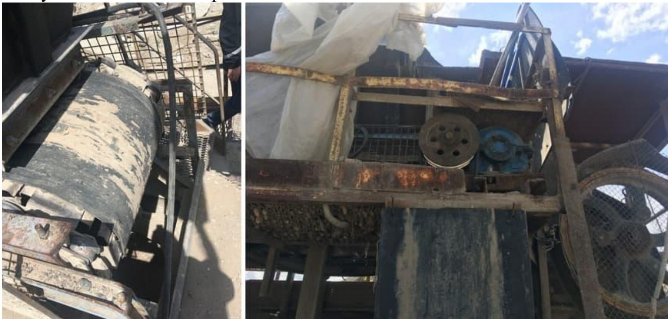
На конвейерах отсутствуют защитные ограждения
