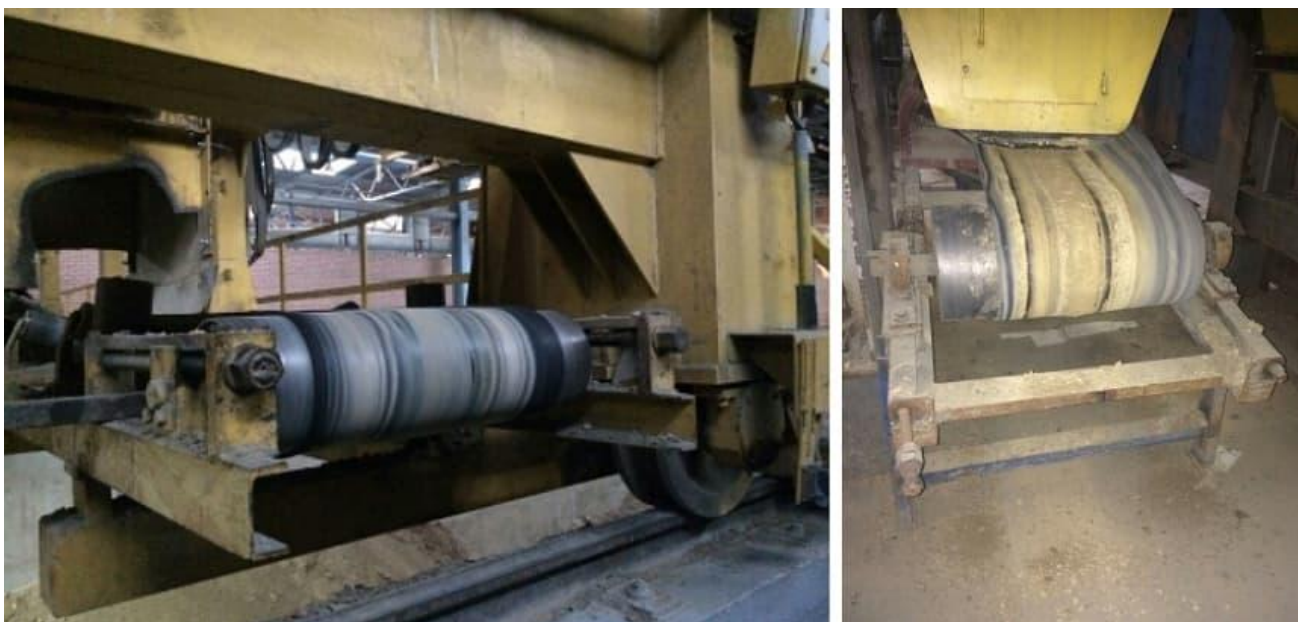
Движущие части конвейера (барaban) не имеет ограждения
