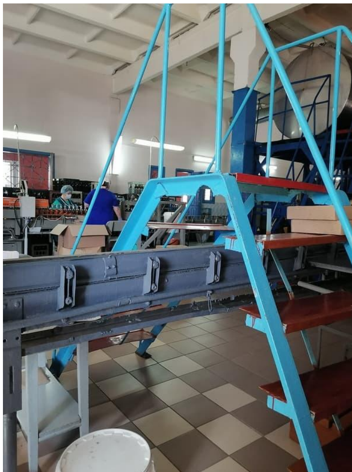
У переходного мостика через конвейер отсутствуют нижний отбойный и средний элементы перильного ограждения
