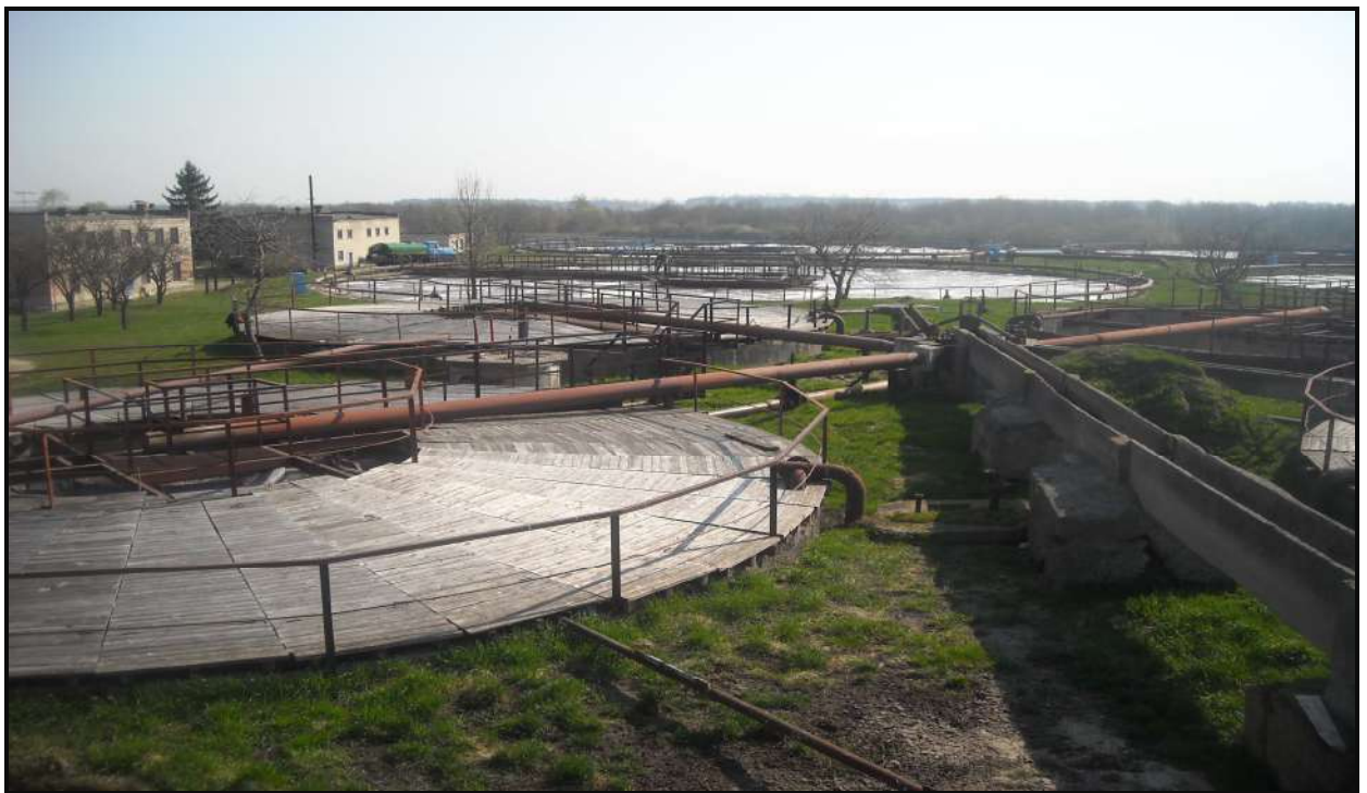
Рисунок 2.1 – Очистные сооружения г. Берёза
