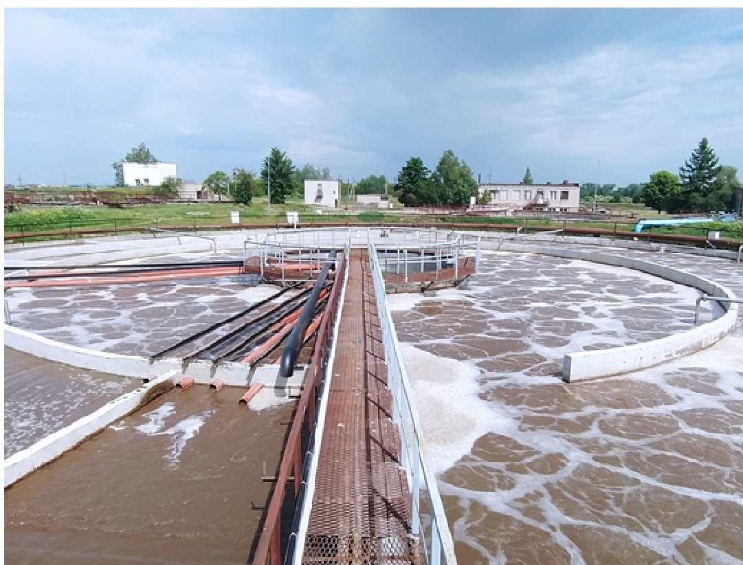
Рисунок 2.2 – Существующие биореакторы очистных сооружений
